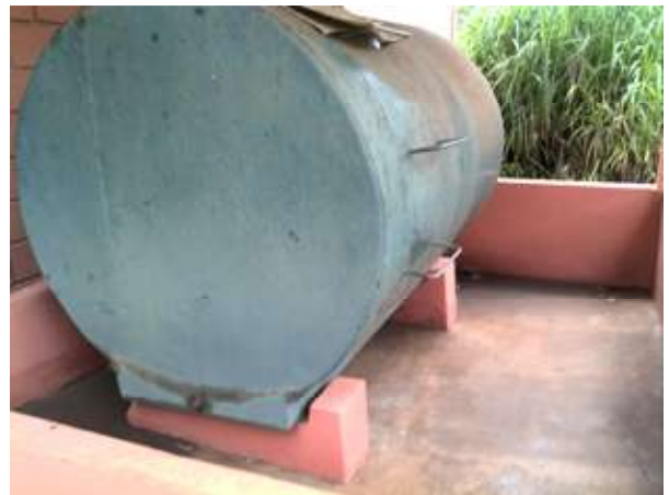
Figura 27. Tanque de combustível
