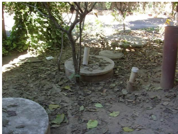
Foto 08. Fossa séptica, filtro e sumidouro
