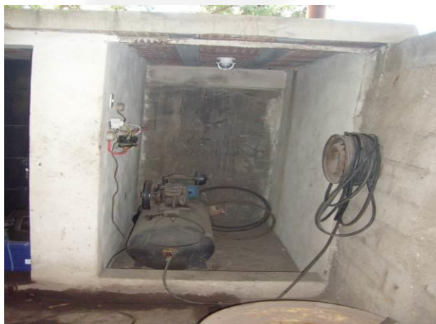
Foto 07. Compressor de ar em área coberta e impermeabilizada
