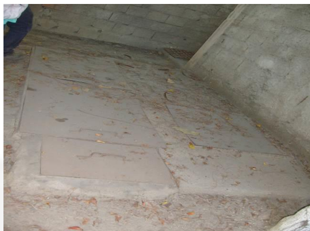
Foto 06. Caixa separadora de água e óleo
