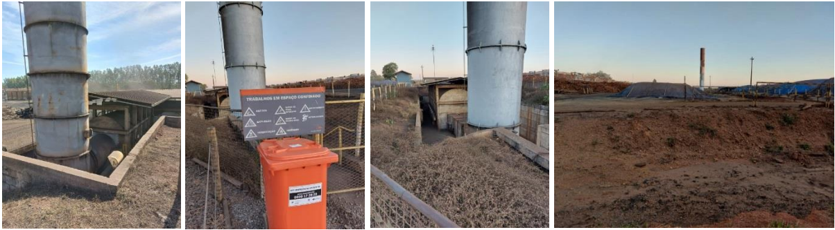
Fotos 13, 14, 15 e 16 – Queimadores de gases implantados nas UPE's.
