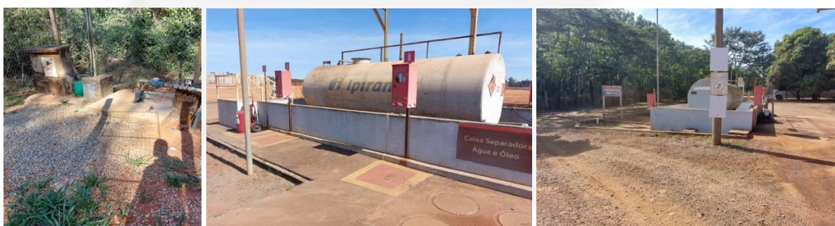
Fotos 4, 5 e 6 – Ponto captação hídrica subterrânea e pontos de armazenamento e abastecimento de combustíveis.
