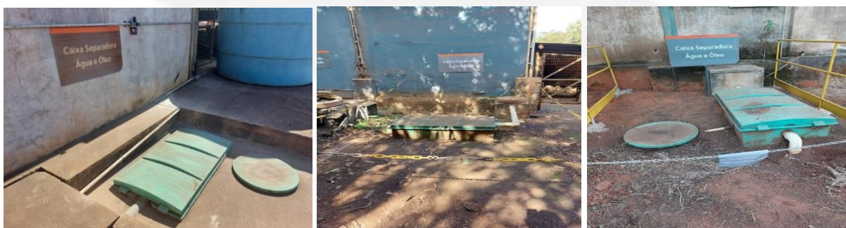
Fotos 10, 11 e 12 – Caixas separadoras de água e óleo das oficinas mecânicas.
