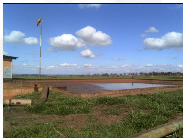
Figura 10: Tanque de águas residuárias
