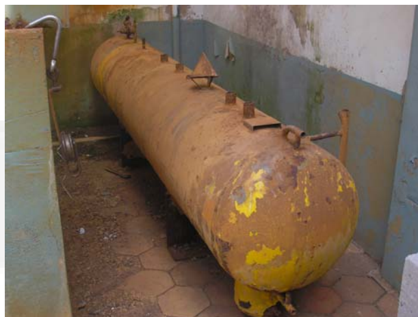
Foto 02. Tanque de amônia
