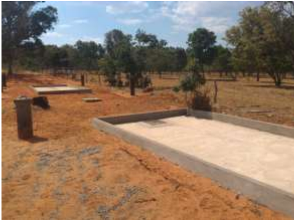
Imagem 05: Sistema de Tratamento de Efluente Sanitário
