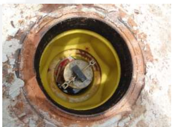
Imagem 04: Pontos de descarga do SASC.
