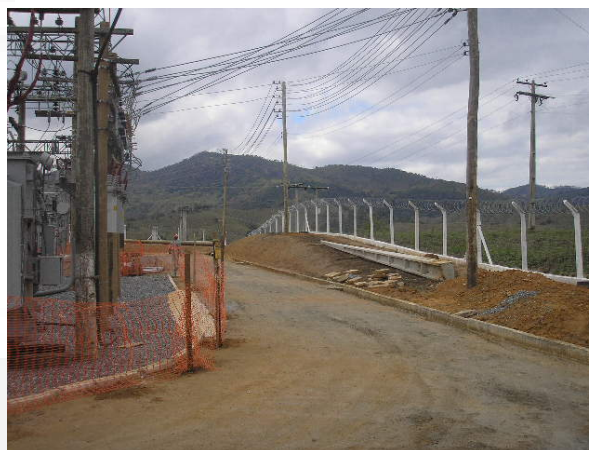
Foto 04. Subestação de Engenheiro Caldas
