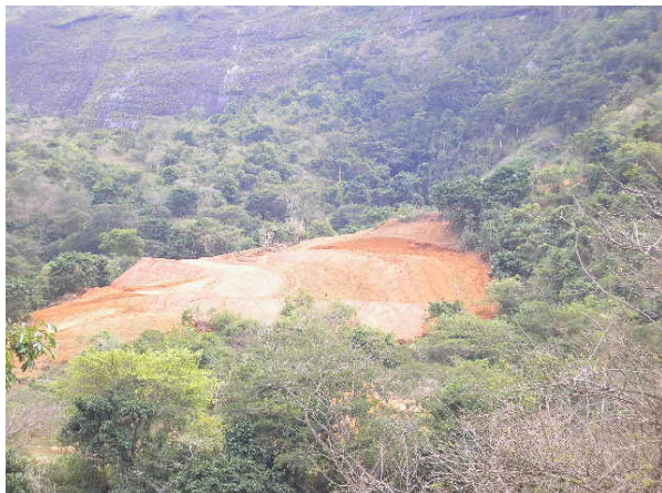
Foto 01. Área de implantação da Subestação e Pórtico da PCH Barra da Paciência no município de Gonzaga
