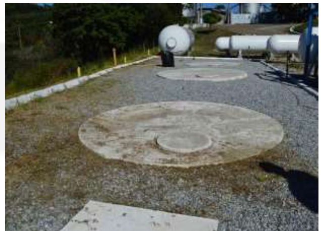
Foto 04. Fossa séptica (sistema fossa-filtro-sumidouro)
