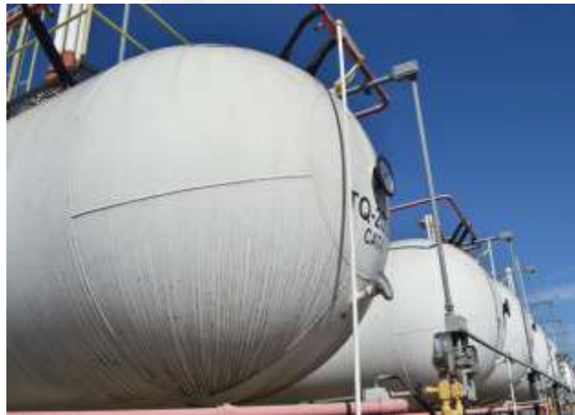
Foto 02. 8 tanques de armazenamento de GLP
