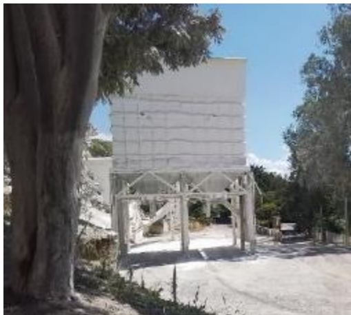
Foto 03. Silo de cal.
