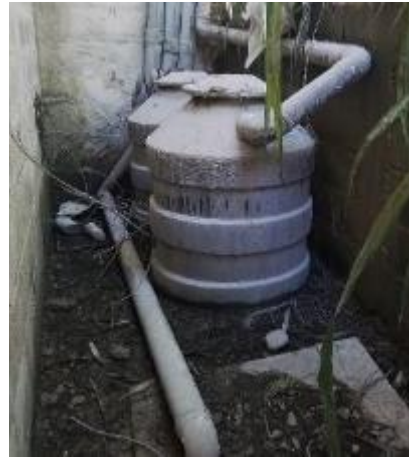
Foto 02. Biodigestor ETE produção
