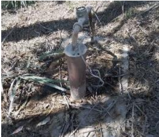
Foto 07. Poço tubular com hidrômetro.
