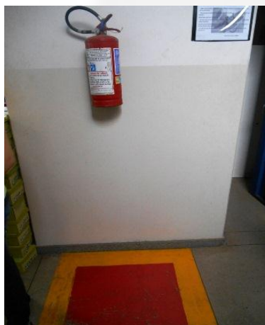
Foto 01. Extintor para combate a incêndio
