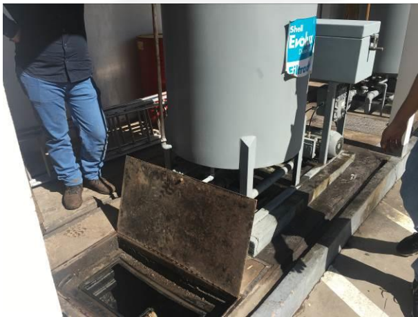
Foto 07. Filtro de diesel.
