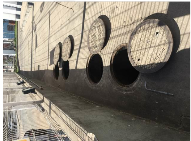
Foto 08. Caixa separadora de água e óleo.
