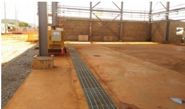
Foto 05. Oficina com canaletas
