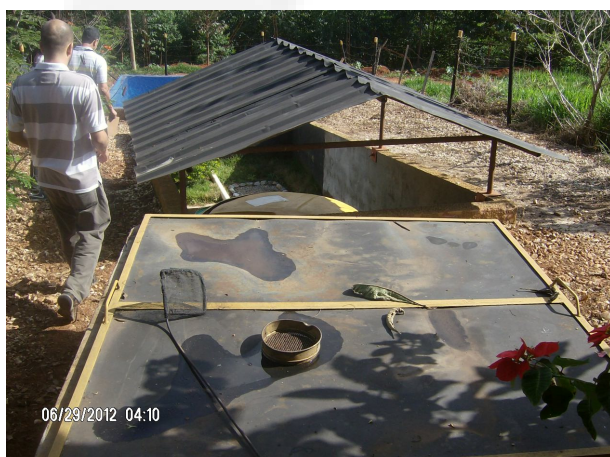
Foto 03. Sistema de tratamento de efluentes sanitários
