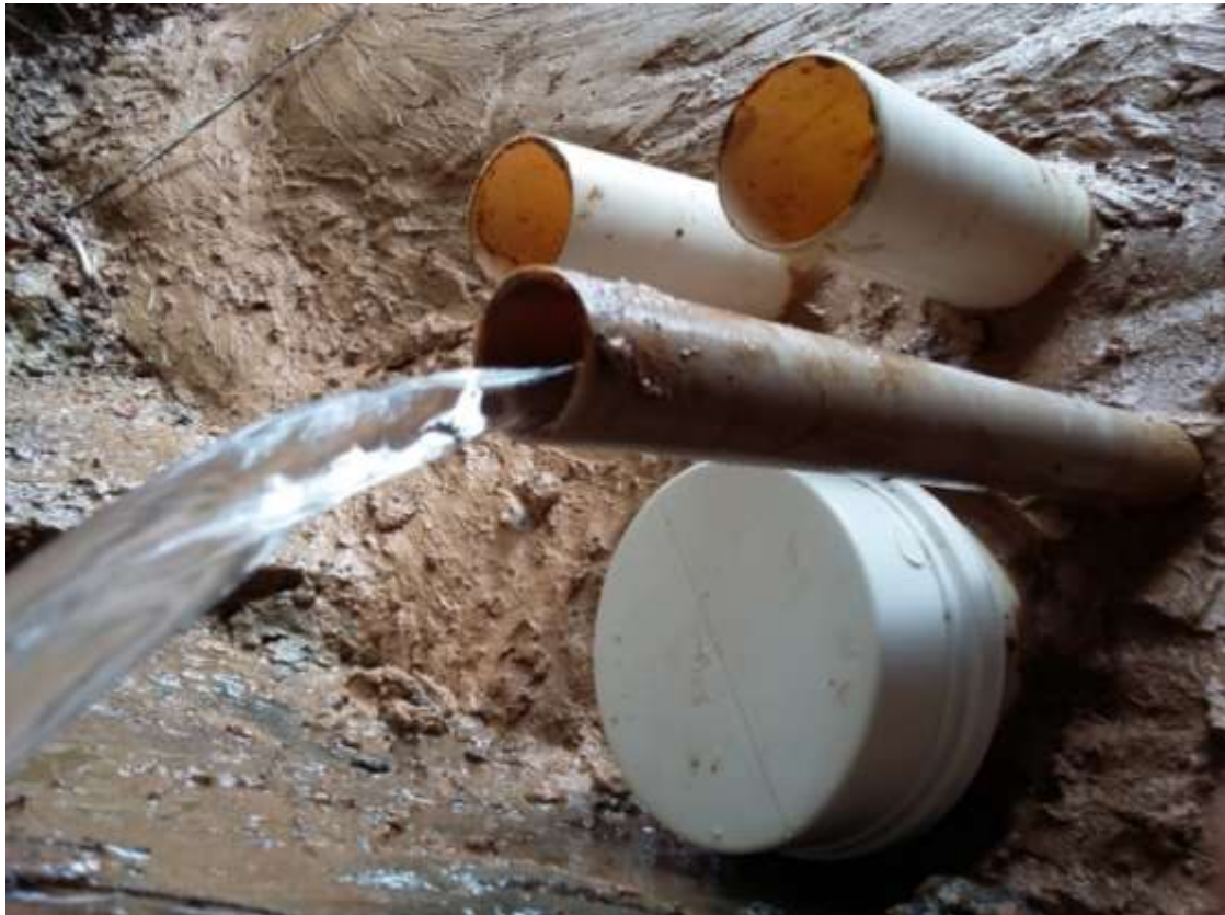
(cano de limpeza, tampado, cano de captação, saindo água, canos extravasores, acima)
