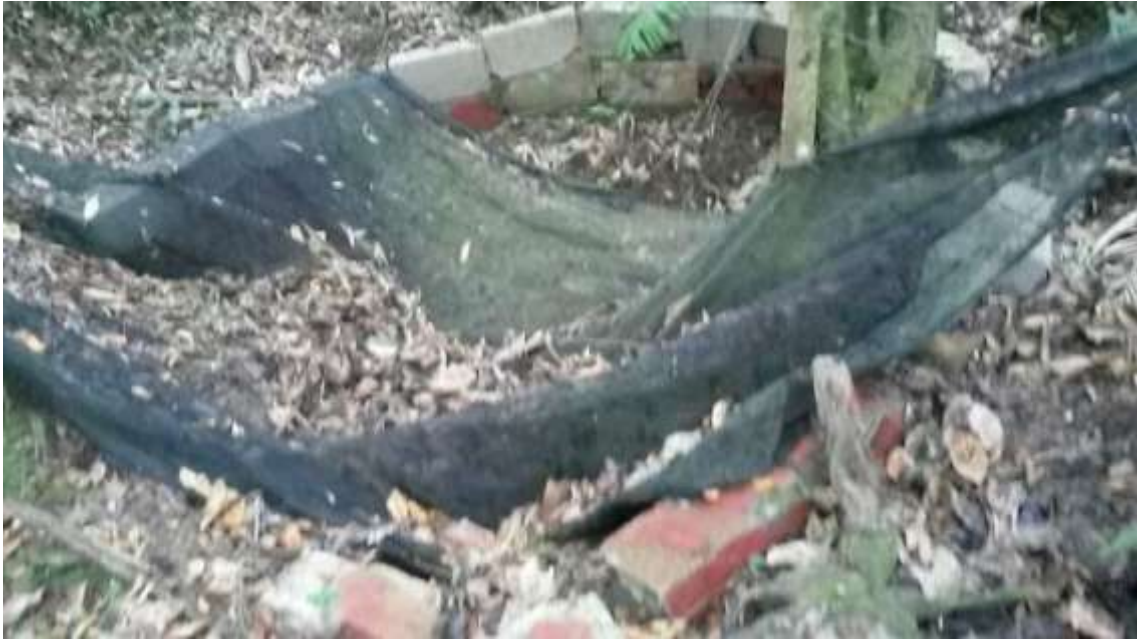
(Condições de captação encontradas)
