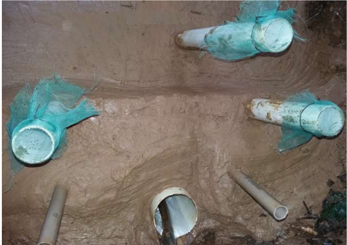
(Canos de limpeza, em baixo no cento, canos de captação, marrons, canos extravasores, com tela na ponta)
