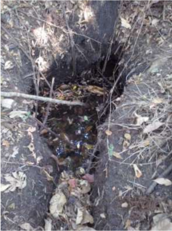
(Condições de captação encontradas)
