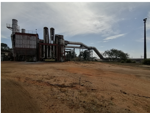
Foto 7: Despoeiramento dos Fornos 1 e 2
