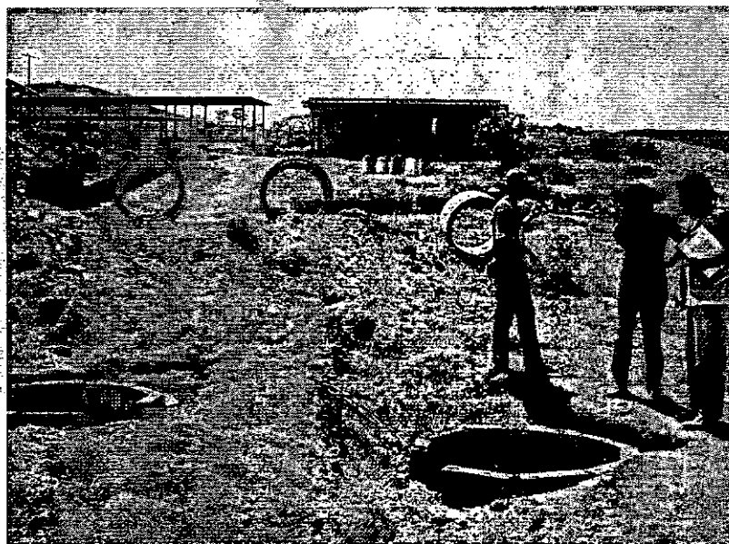
Foto 4. Instalações da fossa séptica.
