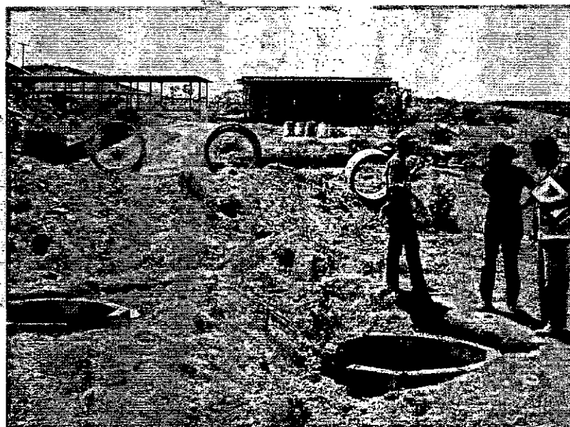
Foto 4. Instalações da fossa séptica.
