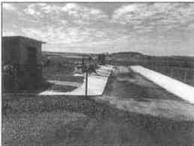
Figura 96. Estação de tratamento de águas – estabelecimento de canais
