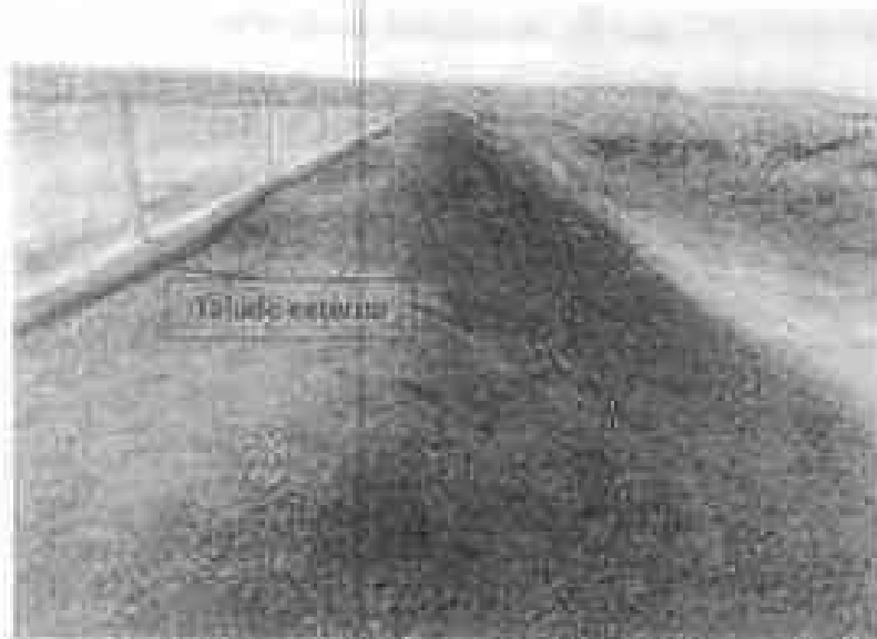
Figura 2 - Vista parcial do talude externo do aterro sanitário Lagoa Comprimento da Favela Delta/Vilaça 3.
