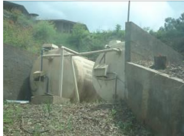
Foto 08. Estação de tratamento de efluentes líquidos.
