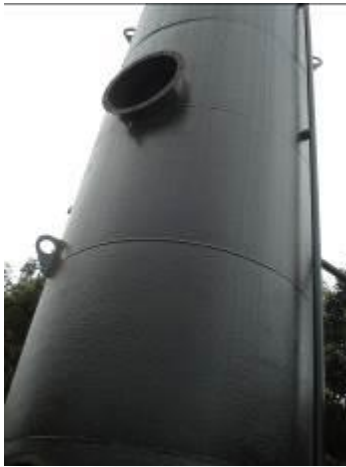
Foto 05. Separador de água e óleo.
