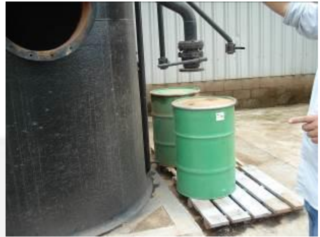
Foto 06. Separador de água e óleo.
