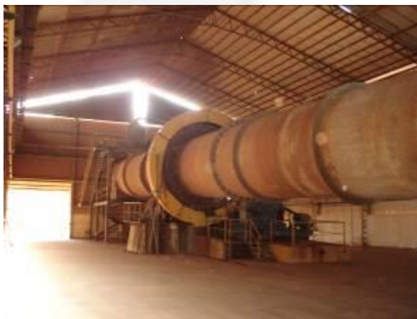
Foto 01. Vista parcial do forno rotativo.
