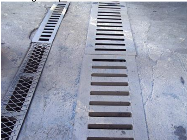
Foto 07. Sistema de drenagem pluvial
