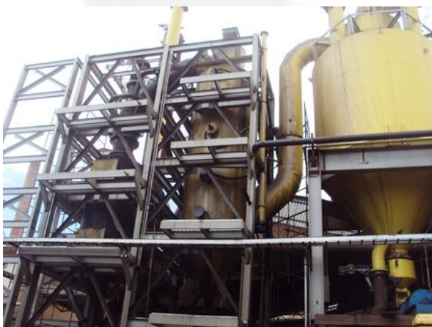
Foto 09. Sistema de limpeza de gás do alto forno
