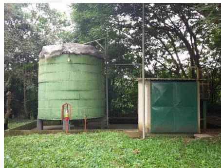
Foto 02. Estação de tratamento de efluentes.
