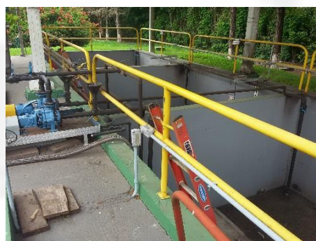
Foto 04. Tanques para condensação de produtos químicos e posterior recolhimento.
