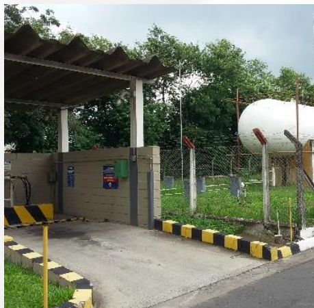
Foto 01. Base de armazenamento de GLP.
