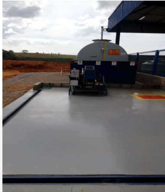
Pista de abastecimento impermeabilizada, com bomba, tanque aéreo e bacia de contenção.
