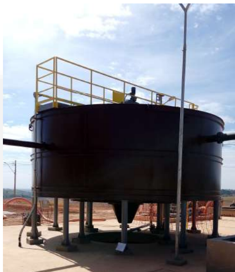
Decantador da ETE Industrial.
