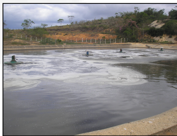
Foto 05: ETE – Lagoa de Aeração.
