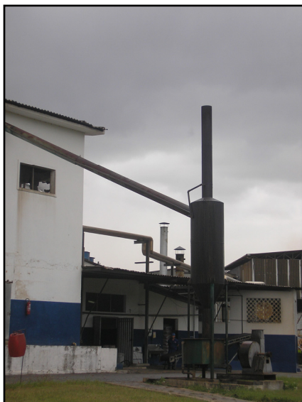
Foto 01: Lavador de Gases da Graxaria.
