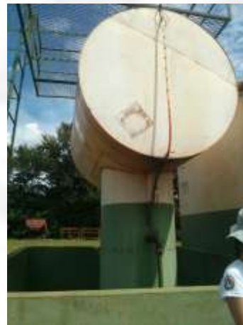
Foto 08. Tanque de armazenamento de combustível
