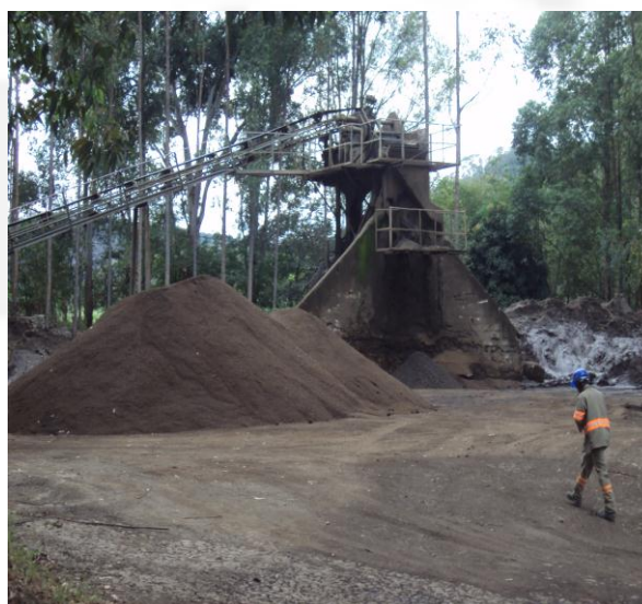
Foto 4: Planta de beneficiamento.
