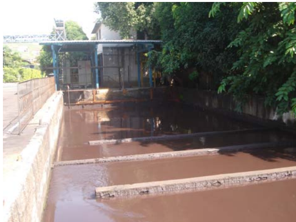
Figura 1: Tanque de decantação
