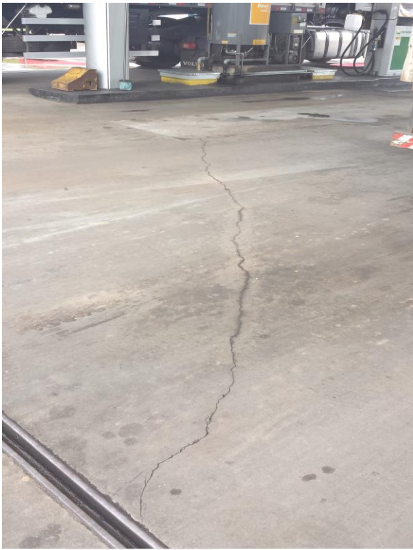
Foto 05. Presença de rachaduras no piso de abastecimento de veículos
