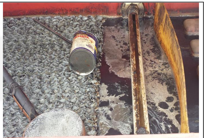
Foto 04. Presença de óleo no efluente na caixa de saída do sistema separador de água e óleo.
