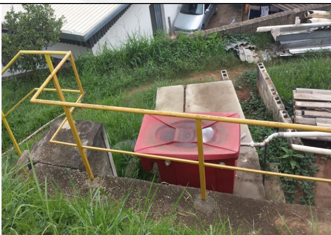
Foto 03. Caixa Separadora de Água e Óleo
