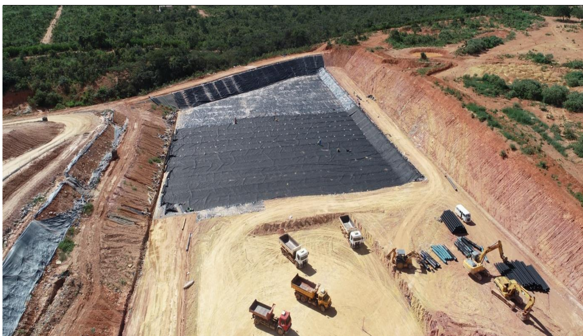
FIGURA 07 – Sistema de impermeabilização de base e taludes (solo compactado + GCL + geomembrana de PEAD) sendo instalados na fundação da Unidade de Aterragem da UVS VIASOLO MONTES CLAROS.
