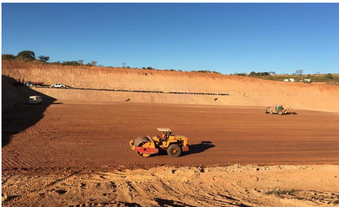
FIGURA 03 – Compactação de solo (umectação + homogeneização + compactação) realizado na unidade operacional da UVS VIASOLO MONTES CLAROS.
