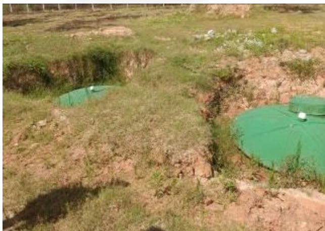
Sistema de Tratamento de Efluente Sanitário
