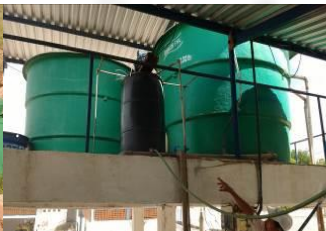
Estação de Tratamento de Efluente
