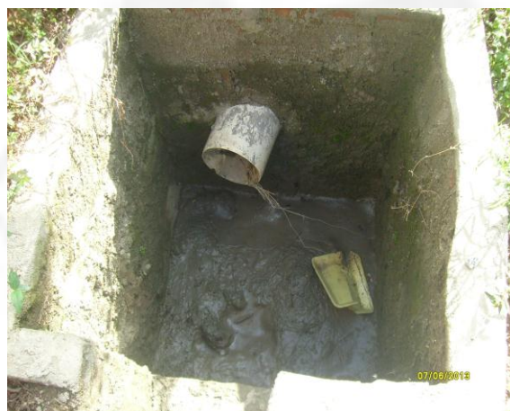
Foto 8: Caixa de sedimentação.
