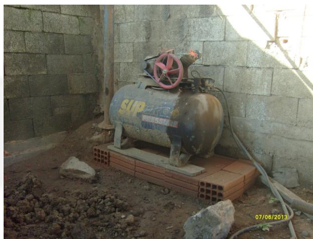
Foto 10: Compressor sem baia de contenção.
