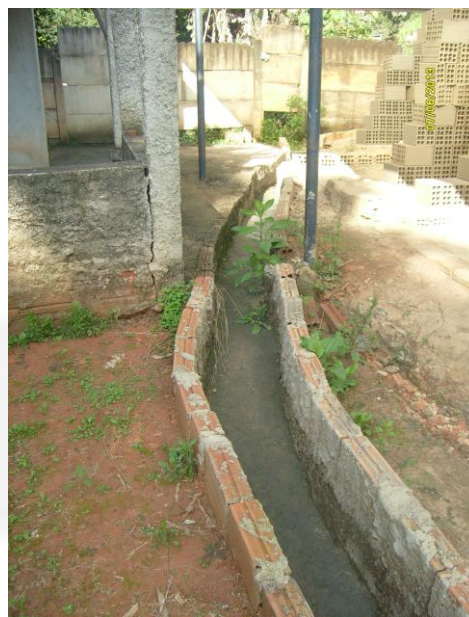
Foto 6: Sistema de drenagem pluvial.
