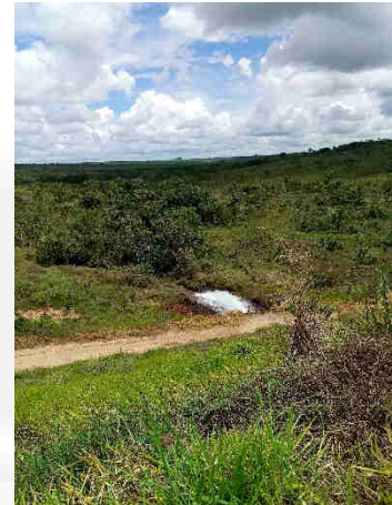
Foto 02. Descarga de fundo do barramento
