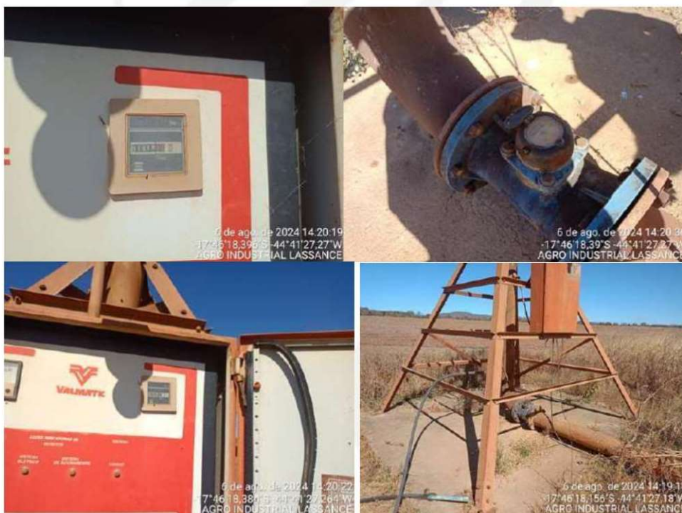
Imagem 1: Fotos do horímetro e hidrômetro instalados
