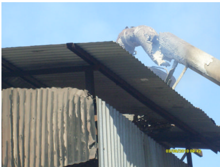
Imagem 01: Sistema de mitigação de efluente atmosférico danificado
