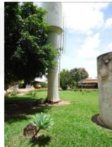
Foto 04. Ponto de captação do poço
