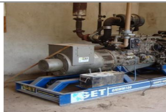
Figura 8: Grupo motor gerador de eletricidade.
