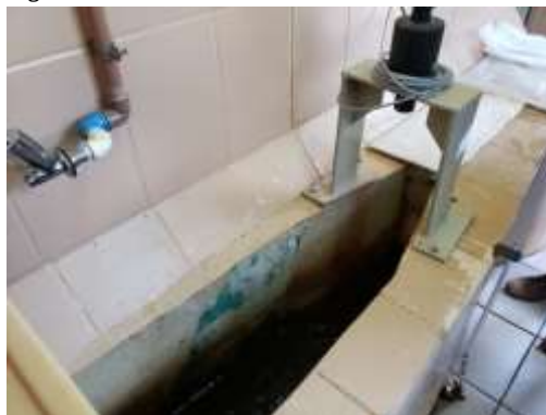
Figura 06. Captação de água - leitura em tempo real
