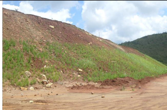
Figura 5. Revegetação de taludes com ausência de plantio no terço superior.
