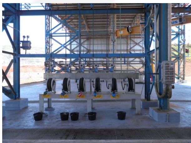
Foto 03. Bombas de abastecimento
