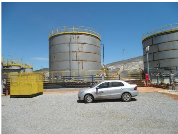
Foto 01. Tanques elevados verticais para armazenamento de óleo diesel
