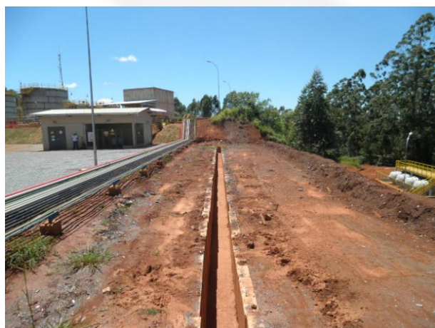
Foto 05. Sistema de Drenagem Pluvial no entorno do posto
