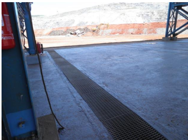
Foto 07. Canaletas de contenção em torno das pistas de descarga e de abastecimento
