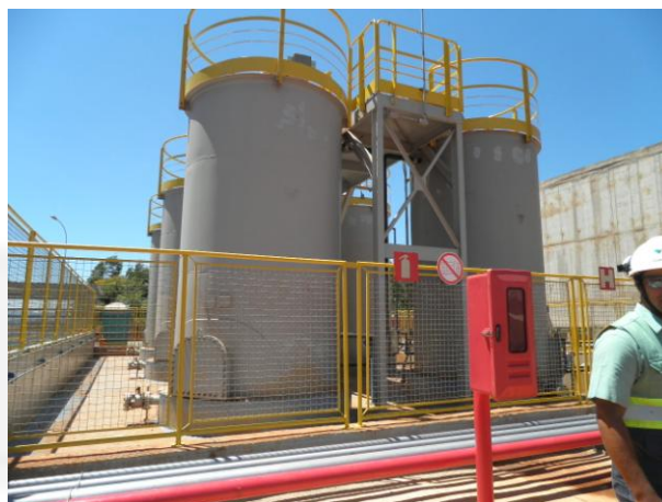
Foto 02. Tanques para armazenamento de óleo lubrificante
