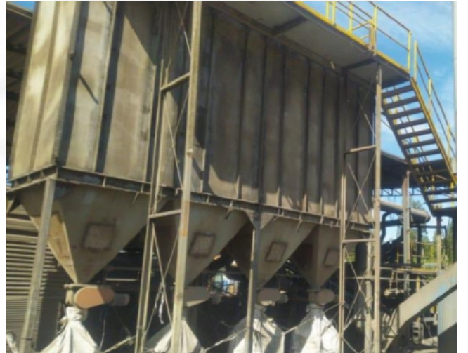
Figura 04: Sistema de despoeiramento composto por 04 filtros manga e 01 chaminé. Fonte: Relatório Técnico de Situação.
