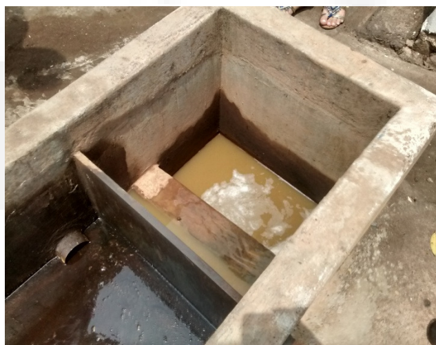
Foto 4: Caixa Separadora de água e óleo
