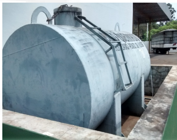
Foto 02. Tanque de armazenamento temporário do efluente oleoso
