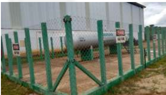
Foto 5: Tanque de Gás GLP
