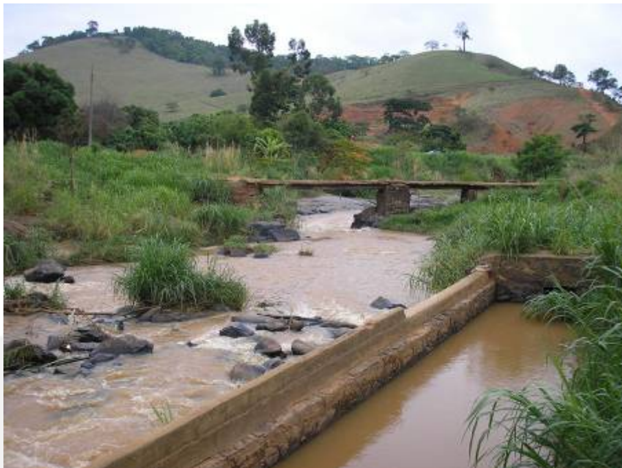
Foto 03: Vista da tomada d'água já existente.
