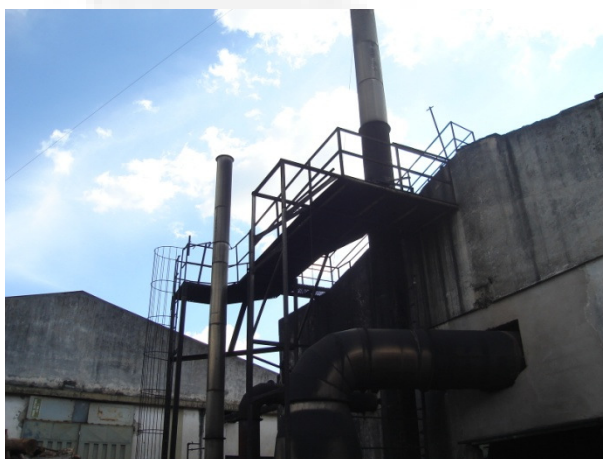
Foto 03. Lavador de gases das caldeiras.
