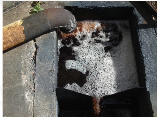
Foto 02. Ponto de lançamento de efluente junto à rede municipal.
