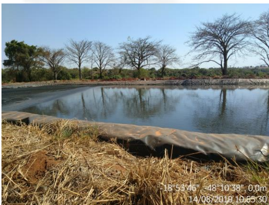
Foto 03. Lagoa de tratamento de efluente.
