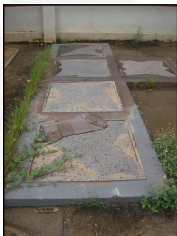
Foto 03. Caixa Separadora de Água e Óleo do empreendimento.
