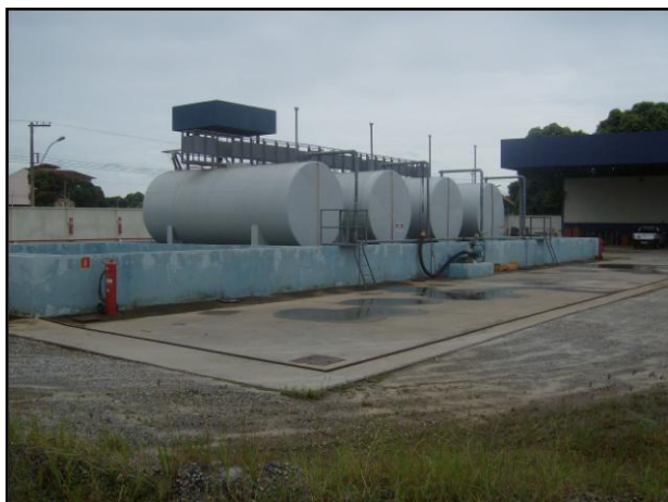
Foto 01. Vista geral dos tanques de armazenamento de óleo diesel.
