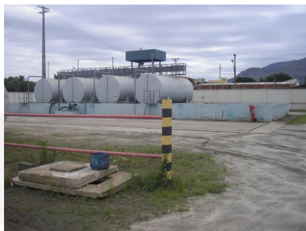
Foto 02. Tanques de armazenamento de óleo diesel.
