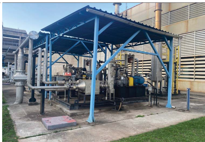
FOTO 12 – Tratamento do biogás na PCT.
