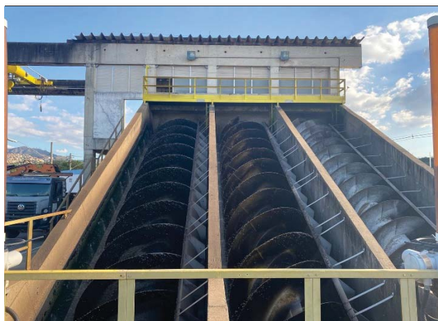
FOTO 5 – Elevatória de lodo.
