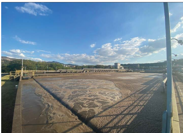
FOTO 3 – Tanque de aeração (reator).
