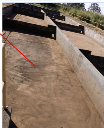
Foto 09. Tanque de captação de águas pluviais
