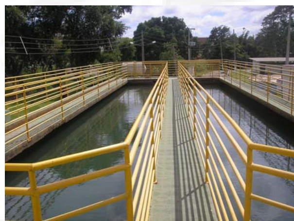
Foto 04. Estação de Tratamento de Água
