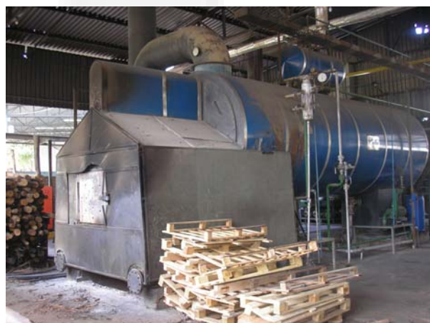
Foto 03. Caldeira a lenha do empreendimento
