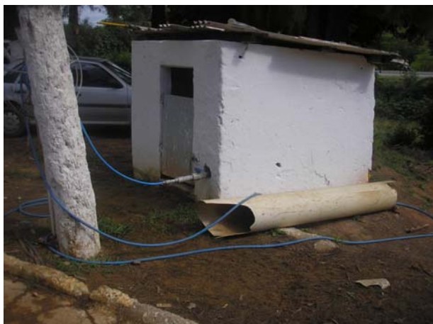
Foto 01. Captação em poço artesiano.
