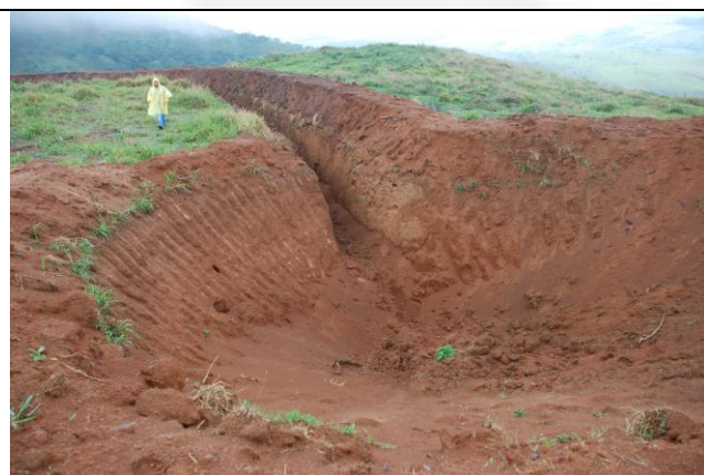
Foto 03: SUMP do sistema de drenagem da futura cava.
