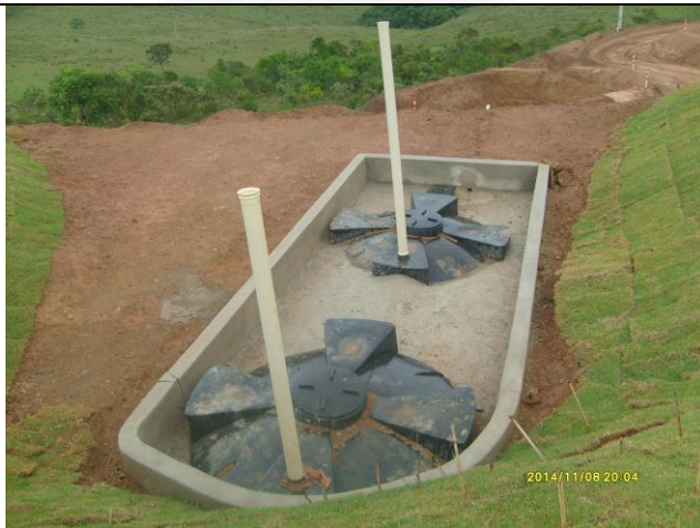
Foto 07: Estação de Tratamento de Efluentes - ETE.
