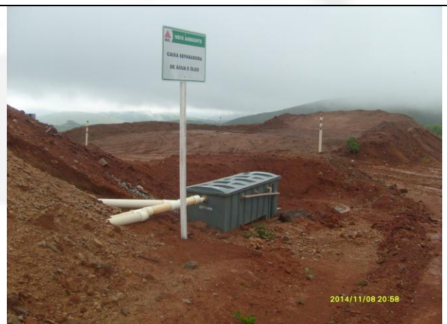
Foto 10: Caixa separadora de água e óleo da oficina.
