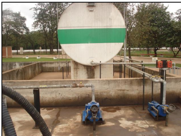
Foto 01. SAAC – Sistema de Armazenamento Aéreo de Combustível.
